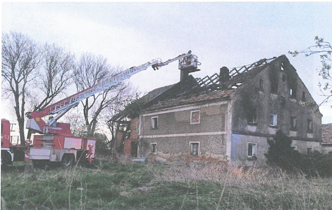
Rysunek 2 Budynek mieszkalny w Godziszowej po pożarze
