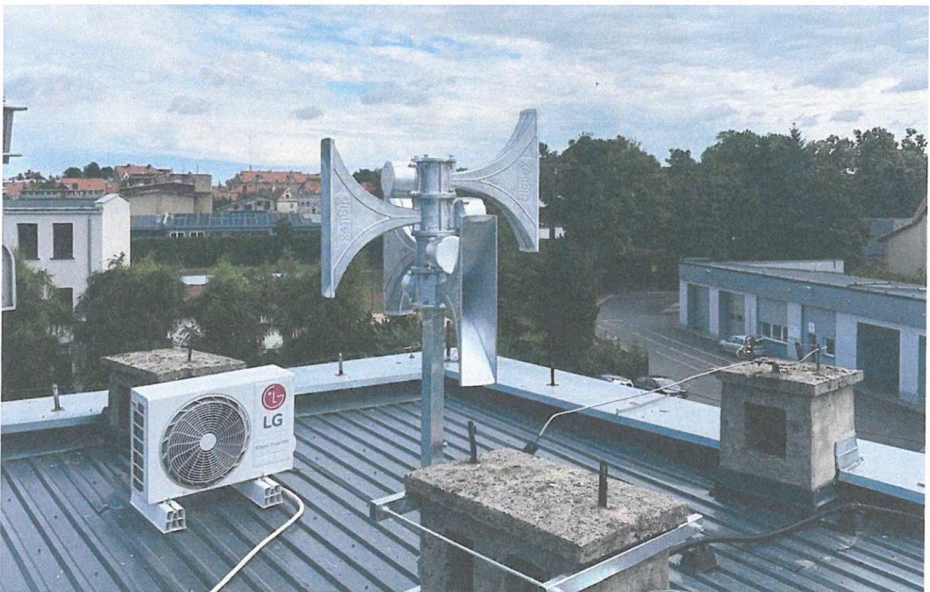
Rysunek 18 Syrena elektroniczna zamontowana na budynku JRG Jawor
