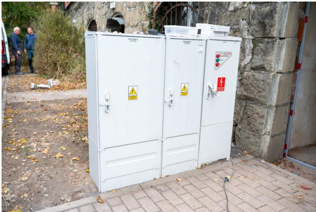
Fot. IX.1.21-22.: Instalacja elektryczna w pałacu w Muchowie
